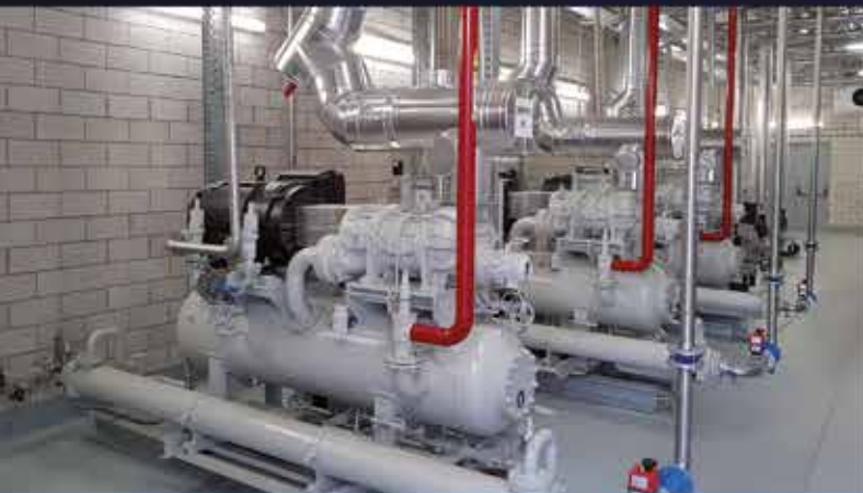
Planta de refrigeración de amoniaco
