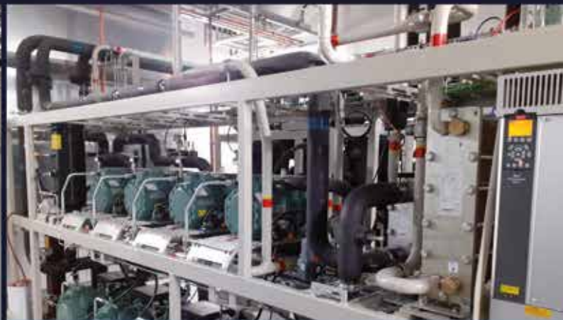
Planta de refrigeración de CO 2
