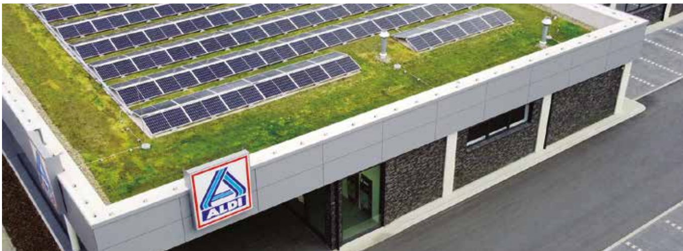
Placas fotovoltaicas. Foto: ALDI.
