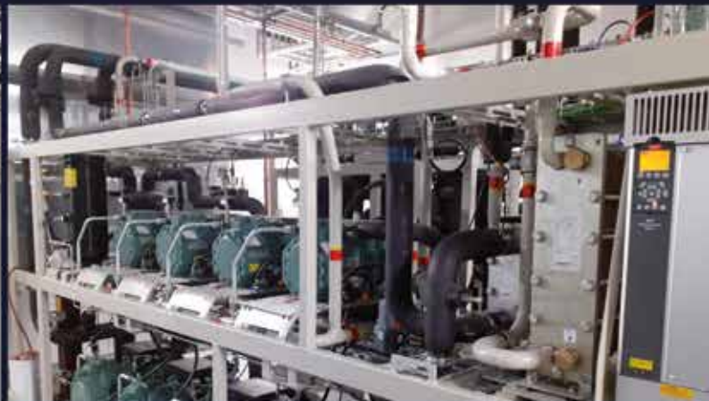
Planta de refrigeración de CO 2
