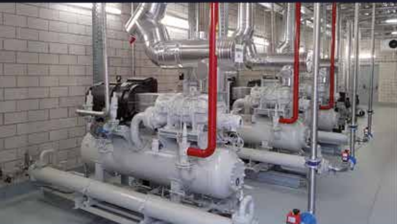
Planta de refrigeración de amoniaco
