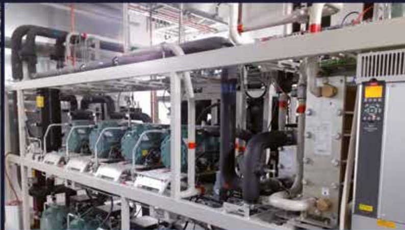
Planta de refrigeración de CO 2
