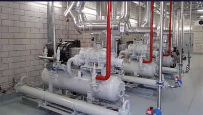
Planta de refrigeración de amoniaco
